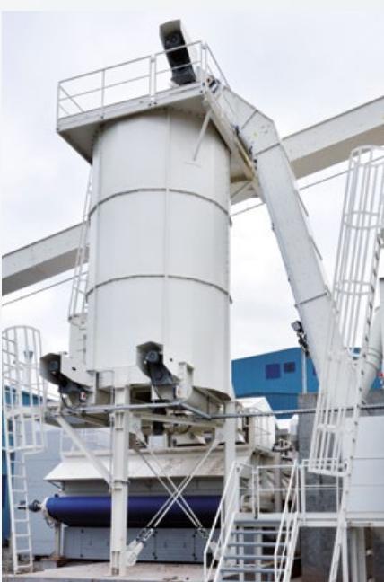
Dosierbehälter mit Rotoraustrag
