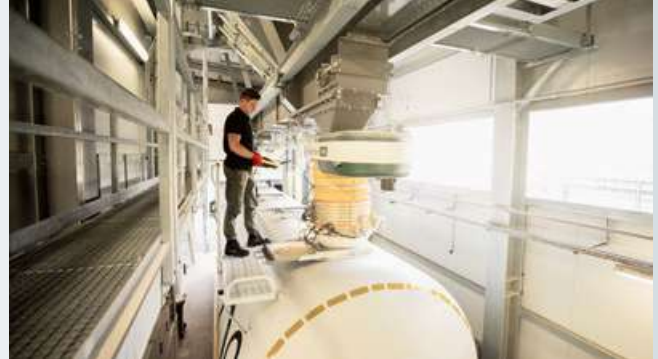
Bequeme, sichere und schnelle Befüllung von Tankfahrzeugen
