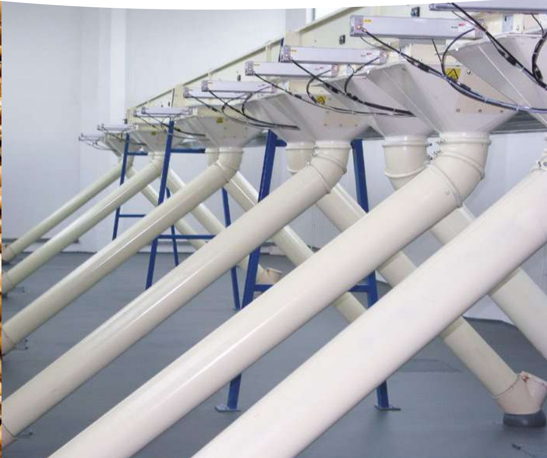
Silozellenbeschickung mittels Trogkettenförderer und pneumatischer Absperrschieber
