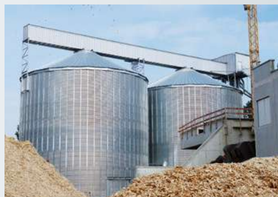
Pelletslager und -umschlagsilos mit Befüll- und Verladetechnik
