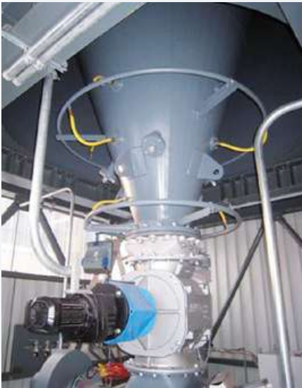
Siloaustrag mit Absperrschieber und Zellenradschleuse
