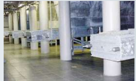
Abzugsstrangkettenträger in einer Kläranlage
