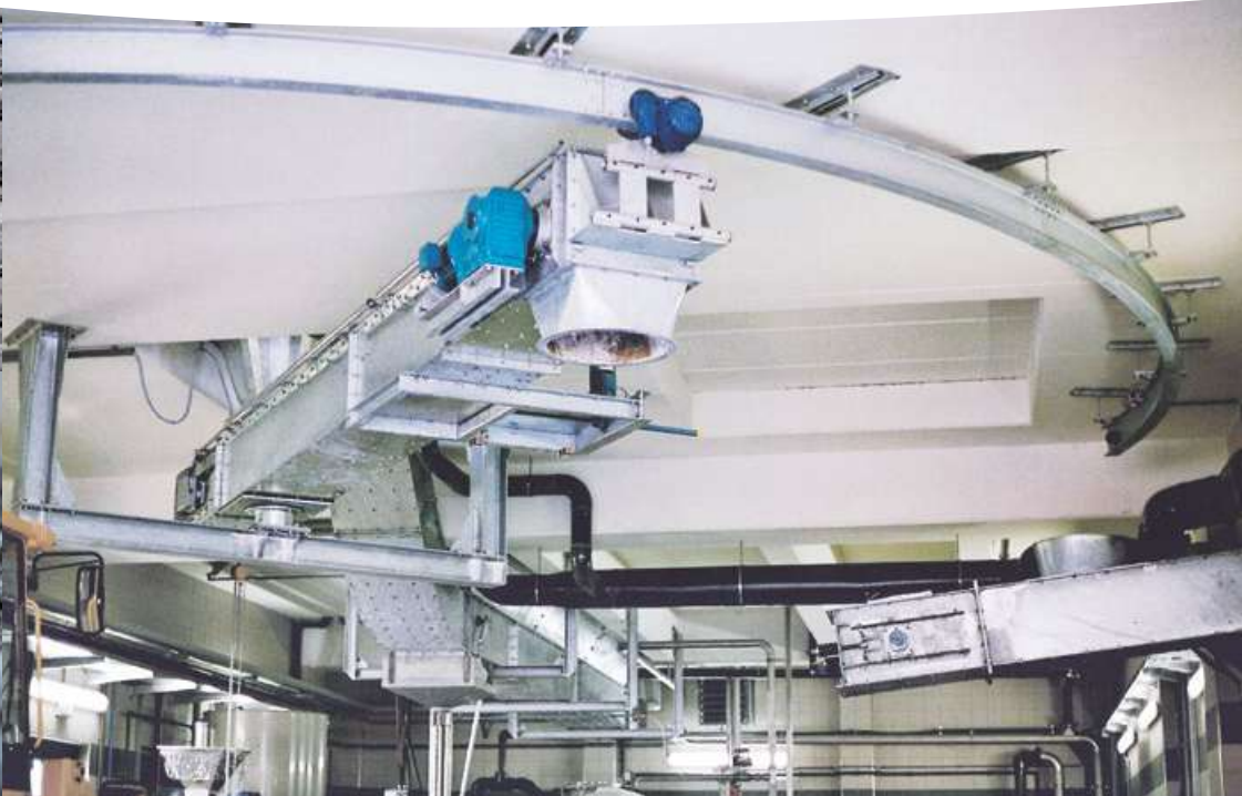
Klärschlammverladestation mit schwenkbarem Trogkettenförderer in einer Kläranlage
