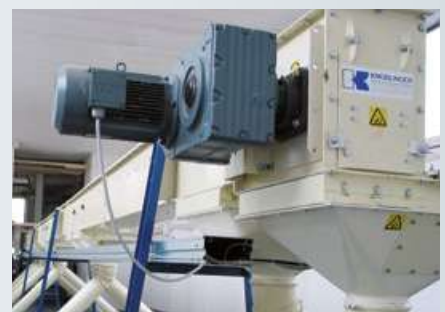
Antriebsstation zu einem Trogkettenförderer
