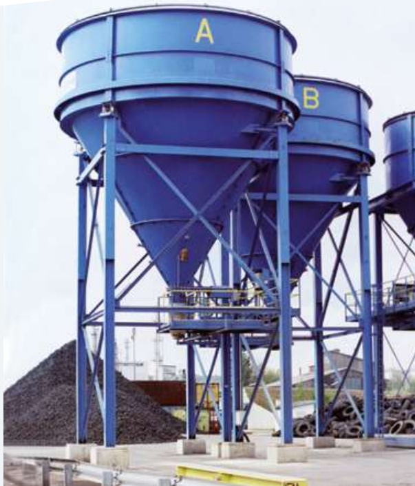
Umschlagsiloanlage in einem Donauhafen
